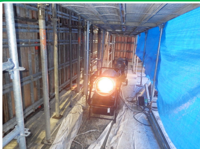
《ジェットヒーターの使用状況》
